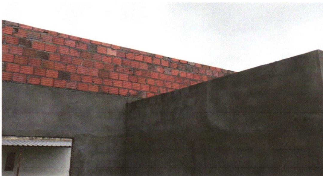
FOTO 01 – ALVENARIA DE VEDAÇÃO DE BLOCOS CERÂMICOS FURADOS NA VERTICAL DE 9X19X39CM (ESPESSURA 9CM) DE PAREDES COM ÁREA LÍQUIDA MAIOR OU IGUAL A 6M 2 COM VÃOS E ARGAMASSA DE ASSENTAMENTO COM PREPARO EM BETONEIRA. AF_06/2014
