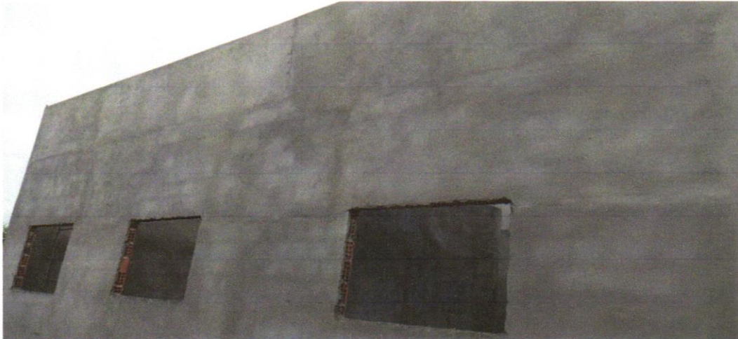
FOTO 03 - MASSA ÚNICA, PARA RECEBIMENTO DE PINTURA, EM ARGAMASSA TRAÇO 1:2:8, PREPARO MANUAL, APLICADA MANUALMENTE EM FACES INTERNAS DE PAREDES, ESPESSURA DE 10MM, COM EXECUÇÃO DE TALISCAS. AF_06/2014
